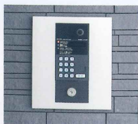
オートロック操作盤
